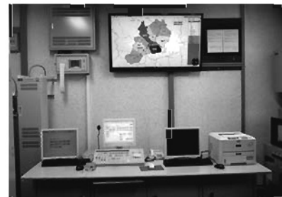
防災行政無線改修事業
