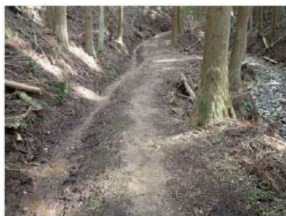
雨水排水用側溝（山粕峠）
