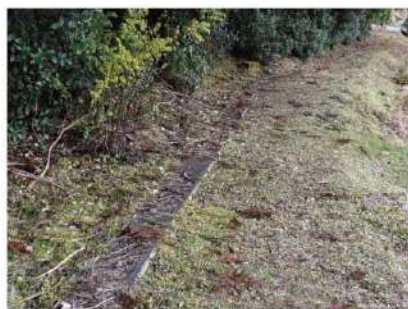
雨水排水用側溝（山粕峠）
